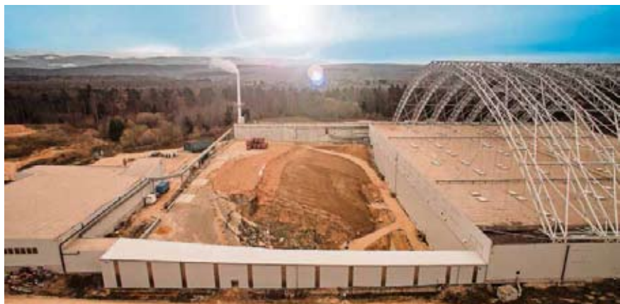
Vue du chantier de Bonfol. Une moitié de la décharge (à gauche) a été vidée de ses déchets et est peu à peu remblayée. Il reste quelques tonnes à excaver sous la Halle hermétiq ue suspendue à des arches métalliques de 40 mètres de haut. (BCI/BETRIEBS AG)
