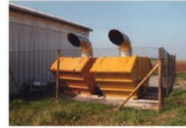
Abbildung 29: AK-Container für Abluftreinigung Zülin Umweltsystem
